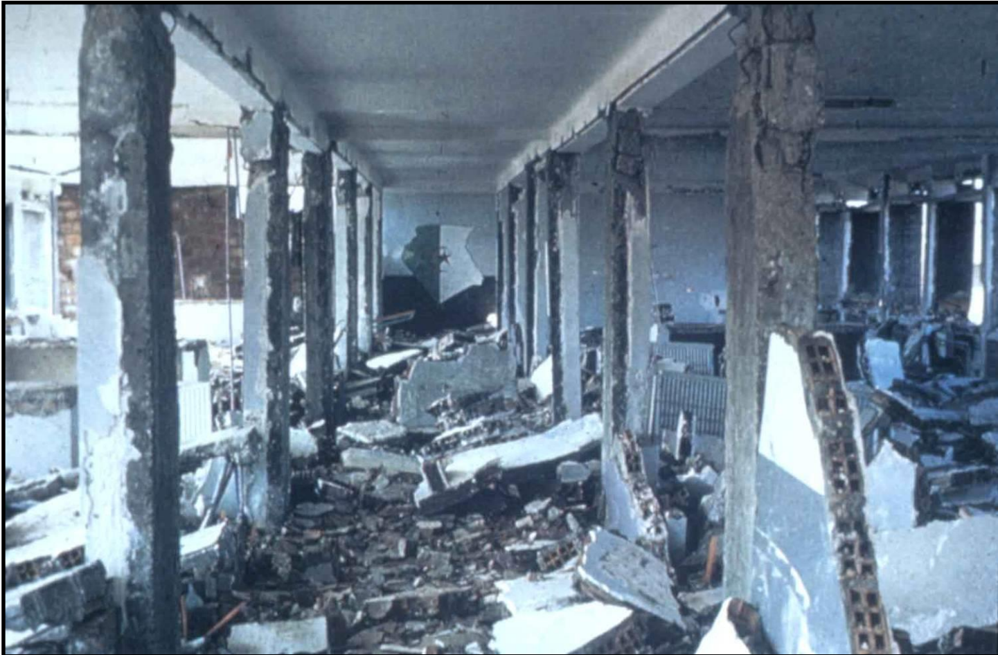
Daños producidos por la interacción de elementos estructurales y no estructurales
